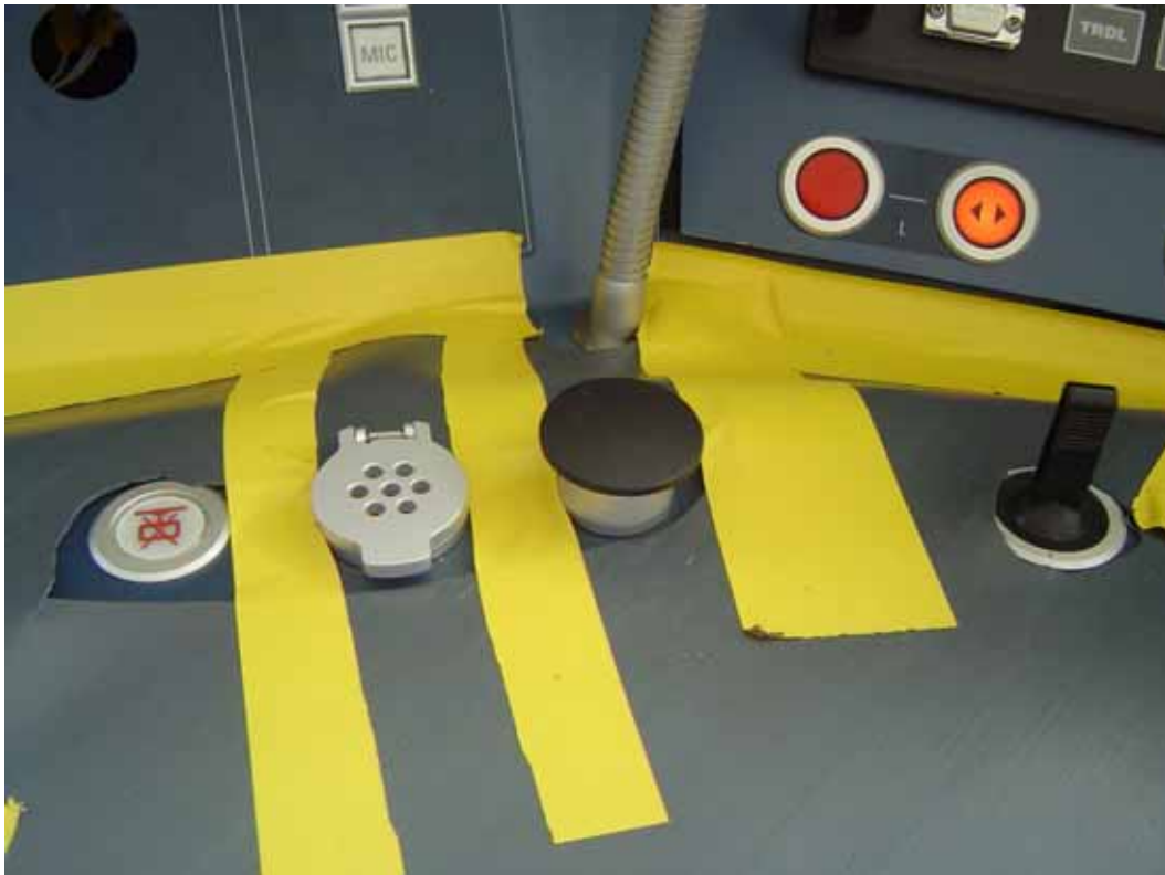
Op de stuurtafel: overbruggen noodrem en nog enkele schakelaars die nog in bedrijf moeten worden gezet.
