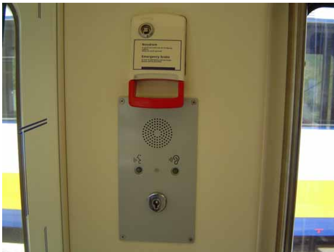
Bij een flink aantal deuren is de omroepinstallatie geplaatst. De conducteur heeft geen eigen ruimte meer voor zijn spullen, die kan hij kwijt in de cabine bij de machinist waar een opbergruimte aanwezig is. Met behulp van de nokkensleutel is de omroepinstallatie te activeren.
